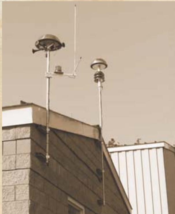
Молниеотвод на современном здании
